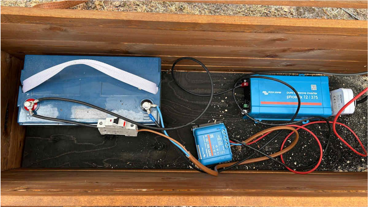
KUVA 5 JÄRJESTELMÄN KESKEISET KOMPONENTIT: AKKU, LATAUSSÄÄDIN JA INVERTTERI SUOJAKOTELOSSA (KUVA: SARI URSIN/YLE).
